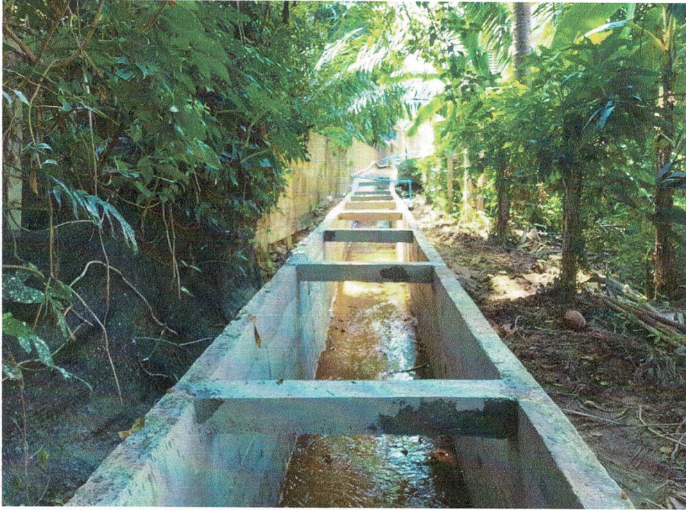
ภาพประกอบโครงการก่อสร้างระบายน้ำ ค.ส.ล.ลำเหมืองสาธารณะ บริเวณ ๗-๑๑ ทางหลวงแผ่นดิน หมายเลข ๑๐๗ เชียงใหม่-ฝาง ถึงศาลาเอนกประสงค์ หมู่ที่ ๔
